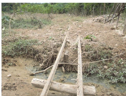
Figura 52: Trilhos da EFPP, junto das ocupações residenciais e industriais, em precário estado de conservação.
