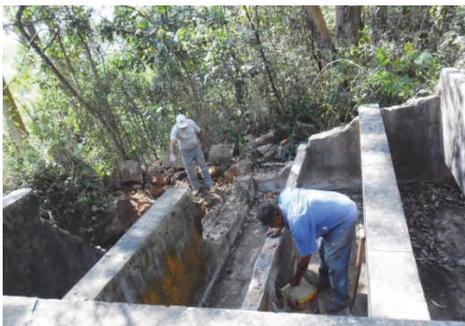
Figura 88: Trabalho de recuperação das caixas d'água após serem atingidas pela queda de um eucalipto.
